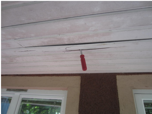
Rötskador under balkongtak
