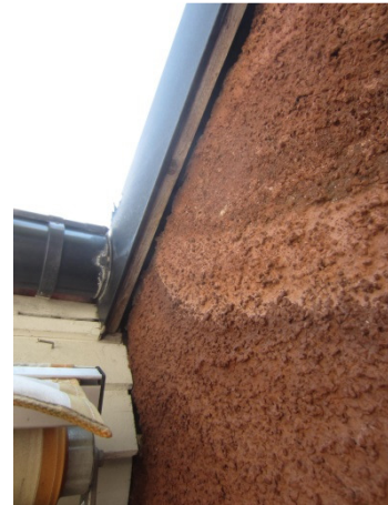
Spår efter fukt på fasad från hängränna
