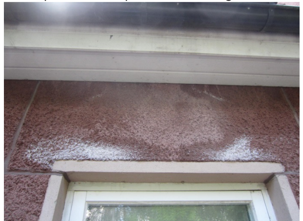
...spår efter fukt under hängrännan
