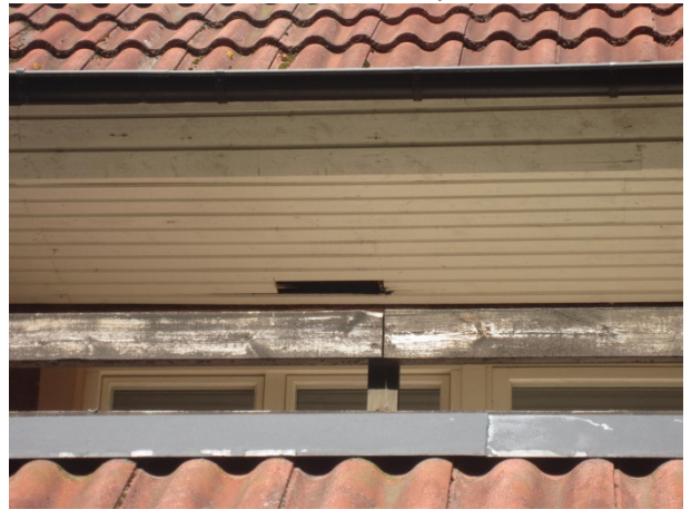
Rötskador under balkongtak
